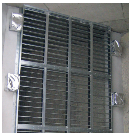
Ensemble de 6 registres MOD montés en batterie dans un tunnel ferroviaire. La section totale = 4300 x 6200 mm.
